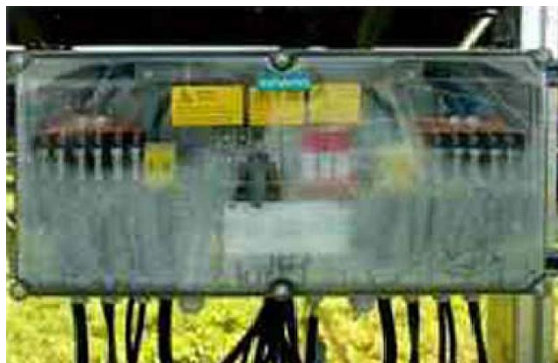
Obrázok A.26 – Príklad nedostatočnej ochrany rozvádzača krytím IP
