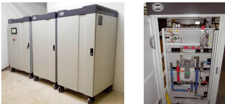
Obrázok 22 – Li-ion úložisko elektrickej energie z FVE
