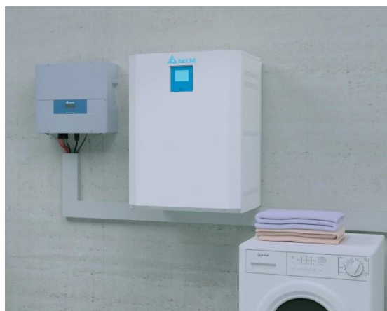
Obrázok 21 – Li-ion úložisko elektrickej energie v obytnom priestore
