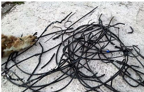
Obrázok A.25 – Následky poškodenia káblov hlodavcami
