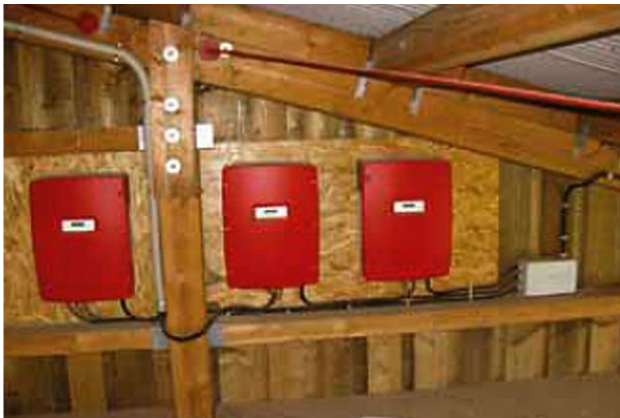
Obrázok 17 – Príklad nevhodnej inštalácie striedačov na drevený podklad
