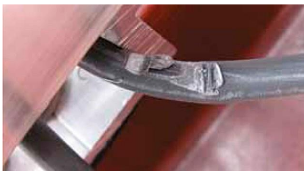
Obrázok A.19 – Poškodenie izolácie kábla ostrou hranou
